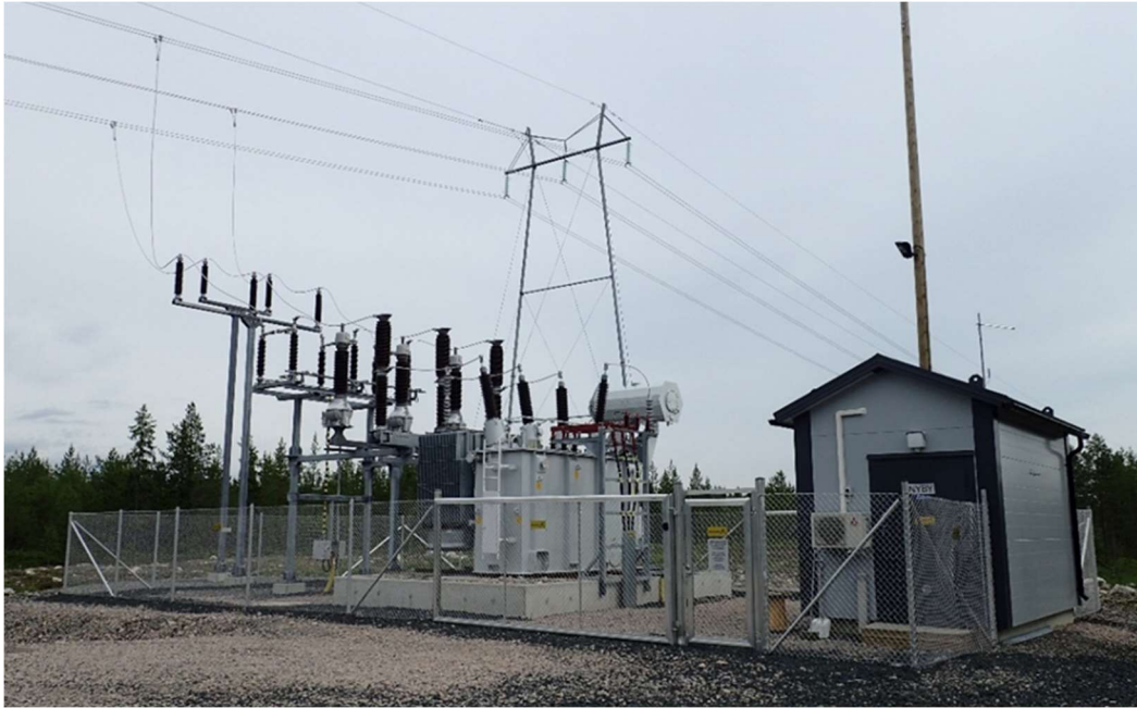
Kuva 90. Esimerkki tuulivoimapuiston sähköasemasta (Kuva: FCG).
